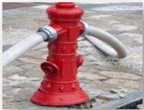
Hydrant na ulici
