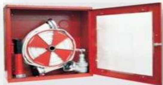
Hydrant v budove
